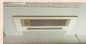
居室エアコン
